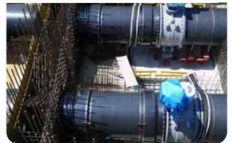
Φ1650 浄水場内、流入と流出管路で 可とう管を使用
