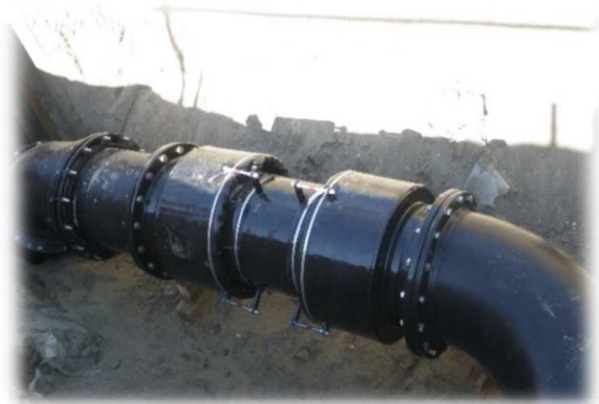
φ800 浄水場内埋設部にて使用【MLW】
