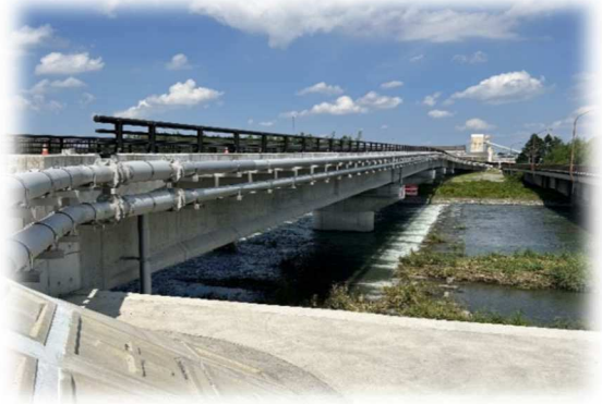
φ300 橋梁添架管で使用
